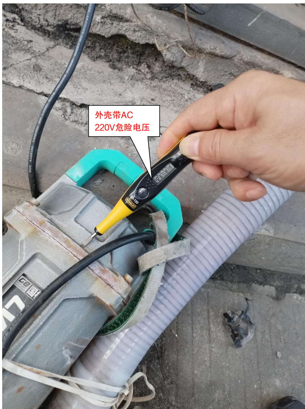
图5 现场测得外壳带AC 220V危险电压
