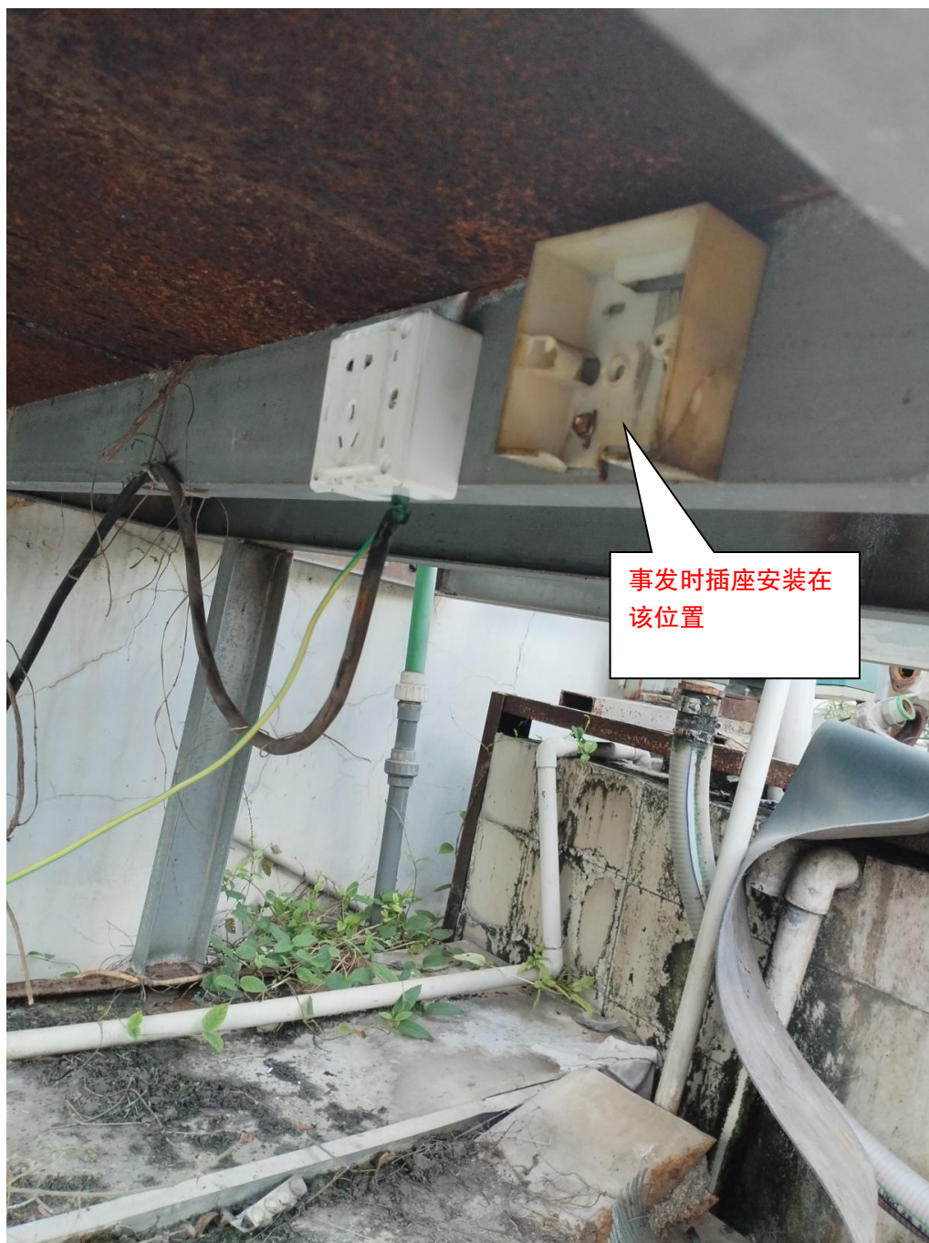
图8 直接安装在槽钢上的插座
