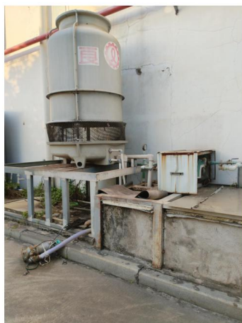
室外冷却水系统
