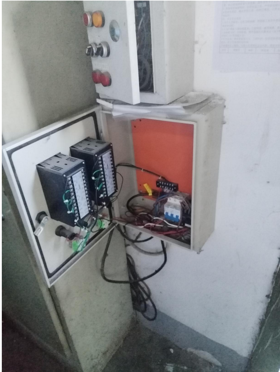
图7 冷却水塔配电箱和控制箱
